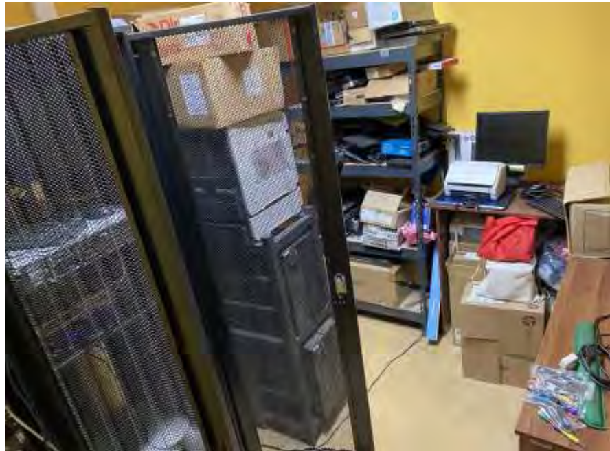
Imagen N° 1: Sala de servidores de la Municipalidad de Dalcahue
