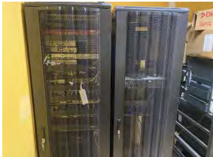
Imagen N° 2: Sala de servidores de la Municipalidad de Dalcahue
